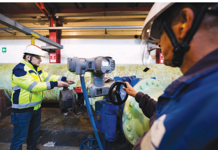
Scudillo – Centrale di sollevamento "Pagliara"
