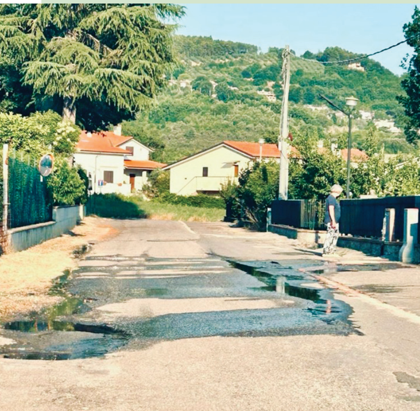
Fig.1: Perdite idriche "non occulte" in una zona periferica di una rete di distribuzione
