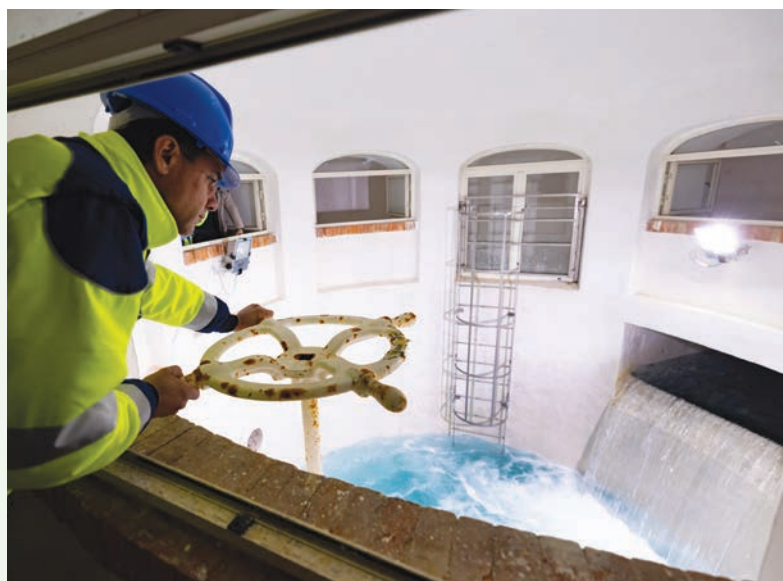
Sorgenti Acquaro-Pelosi – Camera di confluenza canali drenanti
