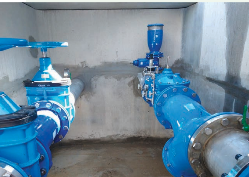
Pozzetto di regolazione e monitoraggio della rete di recente installazione
